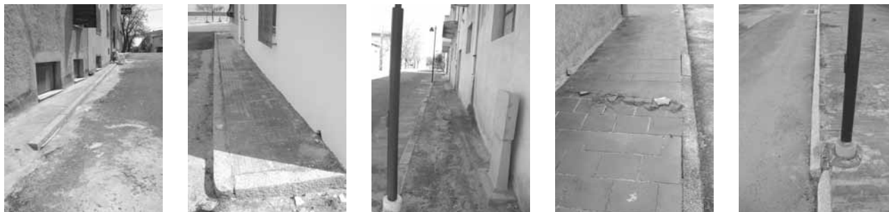
Figg. 9 – 13, Stato di degrado dei percorsi pedonali.
